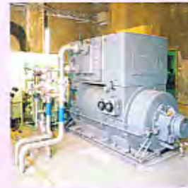
⑤ 蒸気タービン発電機
